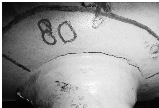
Rys. 3. Badania magnetyczno-proszkowe. Pęknięcie na spoinie pachwinowej króćca odwodnienia [1]
