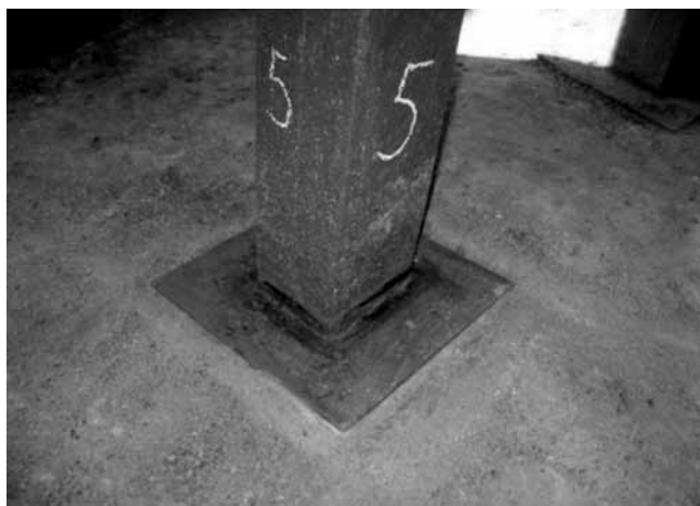
Rys. 7. Stopa podporowa słupa środkowego nr 5 (por. rys. 2 i 3) Fig. 7. Base of foundation middle pillar's No. 5 (see Fig. 2 i 3)
