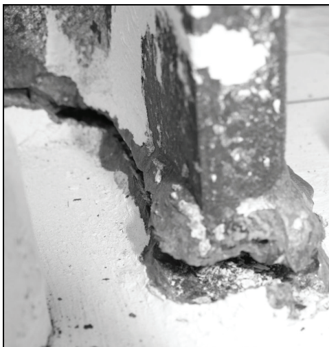
Figura 19. Fractura del cordón de soldadura, fenómeno posterior a una rotación de 0.04 rad.
