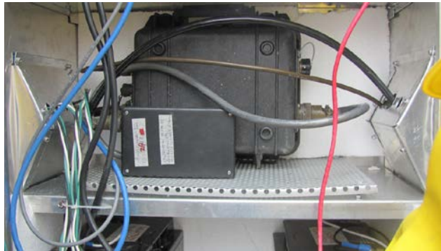
Figura 2. Instalación típica del amplificador T-AMP-3D-48 en una caja de un sistema multiparamétrico, donde puede apreciarse el digitalizador GURALP DM24, al fondo, conectado con el amplificador ubicado al frente. Estación Agua Blanca volcán Puracé Colombia Noviembre 2011.
