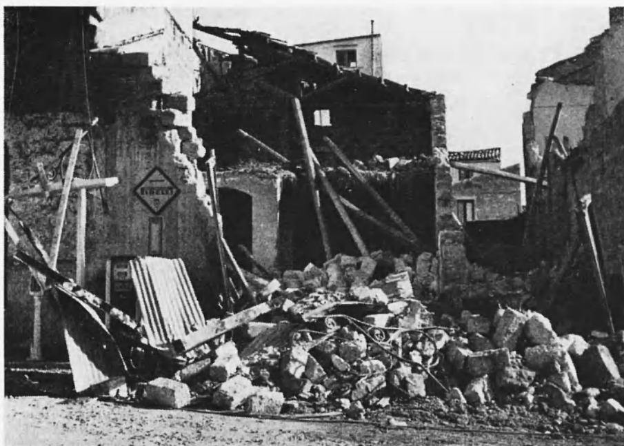
Foto 11. - Montevago - Una abitazione in muratura di blocchetti di tufo completamente crollata.
