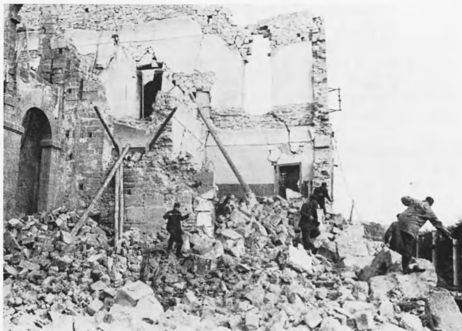
Foto 14. - Salaparuta - Un edificio in muratura di blocchi di tufo distrutto dal terremoto.
