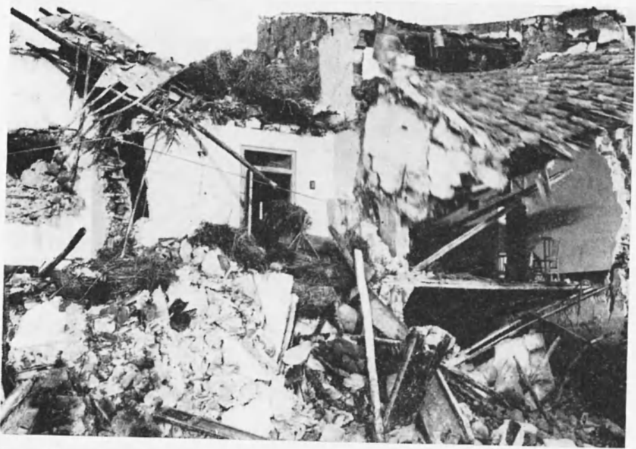
Foto 16. - Santa Ninfa - La povertà dei materiali usati ha reso disastrosi in molti casi gli effetti del sisma.
